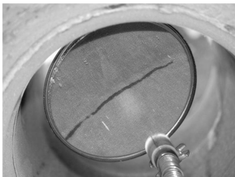
Рис.1. Укрупненное изображение индикаторного следа зафиксированных трещин в сварном соединении приварки тройника к нижней горловине
