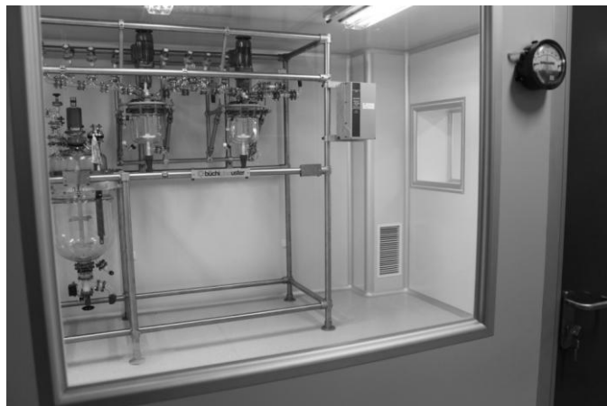
Рис. 2. Оборудование в комнате класса чистоты С
