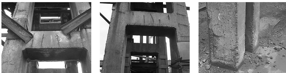
Рис. 1. Наиболее характерные повреждения железобетонных опор эстакад
